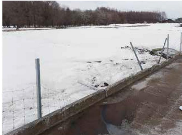
壊れた外周フェンス
